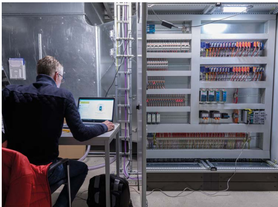
Systeemarchitect Tim de Grouw van Kuijpers was verantwoordelijk voor het integrale ontwerp van de gebouwautomatiseringsinstallaties.
