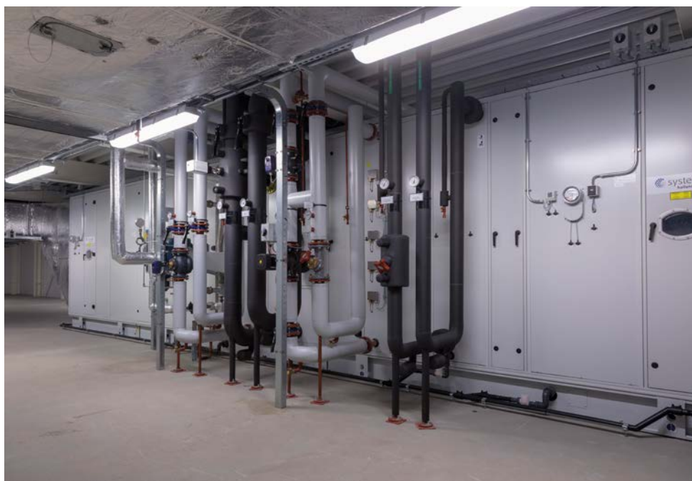
De techniek bepaalt hoe mensen daar straks werken, hoe processen in een gebouw verlopen.
